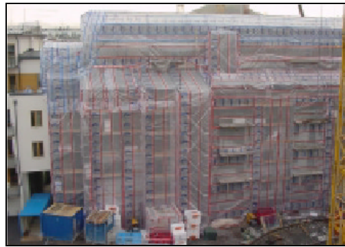
Figur 9. En inklädd fasadställning med tak.
